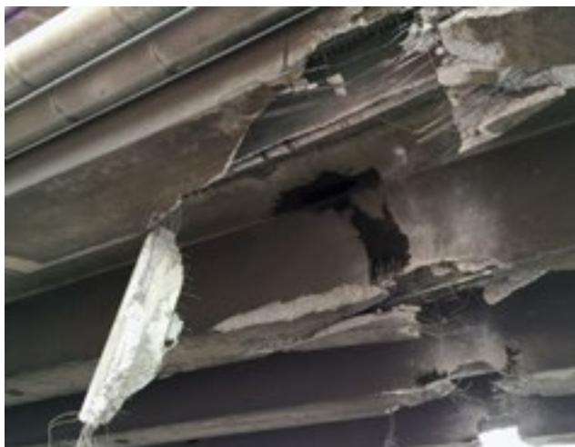
Der Ausleger zerschneidet die Hohlkastenträger. Die Hüllrohre mit den Vorspannkabeln wurden freigelegt, aber nicht verletzt.
