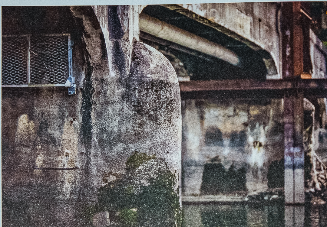
Seit 1960 umhüllt eine Zementmörtelschicht die Stahlkonstruktion. Darunter sammelt sich Wasser und verursacht Frostschäden.
